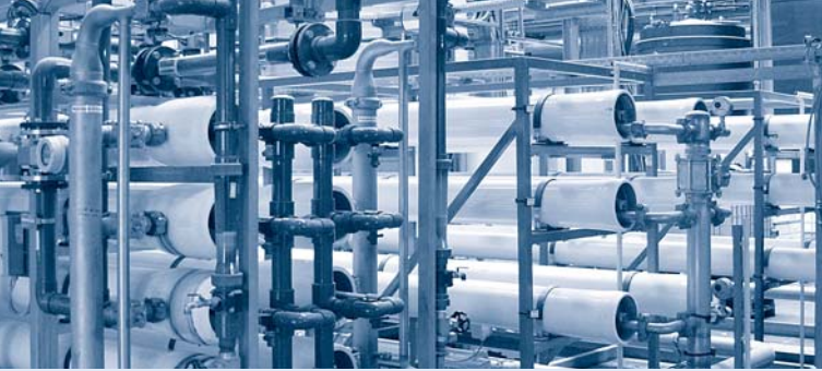
Umkehrosioseanlage zur Aufbereitung von Abwässern aus der Stärkeindustrie (U. Theilen)
